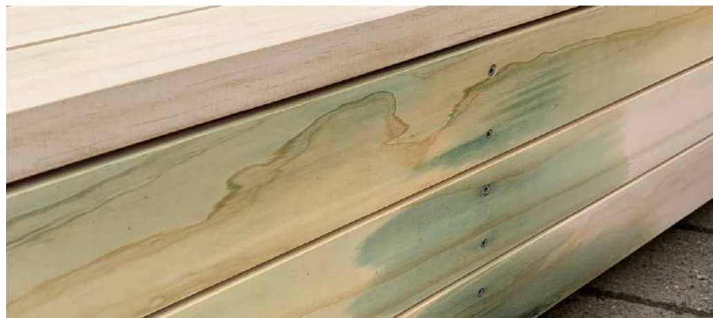
UITLOGING VAN CHEMICALIËN UIT EEN ACHTERCONSTRUCTIE VAN VERDUURZAAMD HOUT NAAR ACCOYA
